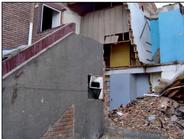
Ilustra los daños de un inmueble para su cuantificación.
